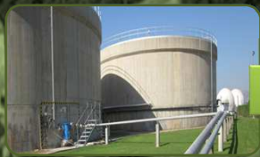
Murcia Este WWTP Digesters and biogas storage
